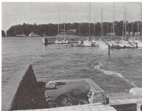
堤防が倒壊し、湾口（左）からのうねりがまとも…。
