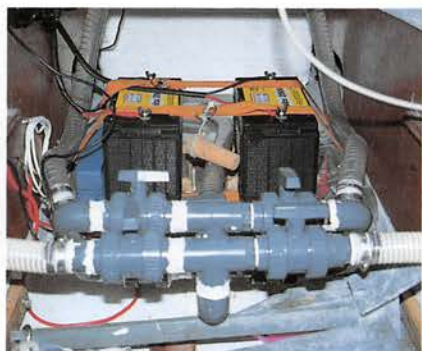
レース艇のほとんどはウォーターバラストを装備している。片舷最大200リッターまでの海水取込みが許され、配管はさながらウィットブレッド60のミニチュア版だ。もちろんミニ・トランサットの方がアイデアとしては先だ。
